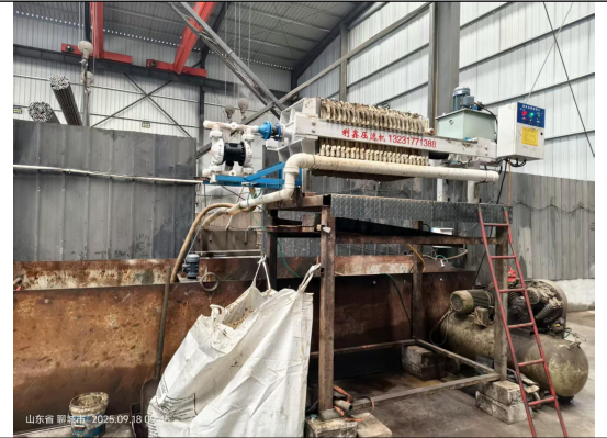
污水处理设施
