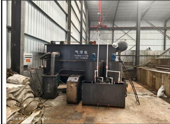
污水处理设施
